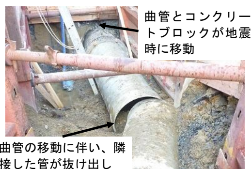
図1 地震による継手の抜け出し（東日本大震災での被害事例）
